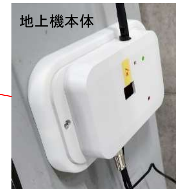
SPC地上機 磁石にて取付。 シャッターの下降を常時監視 100V電源(コンセント)にて作動
